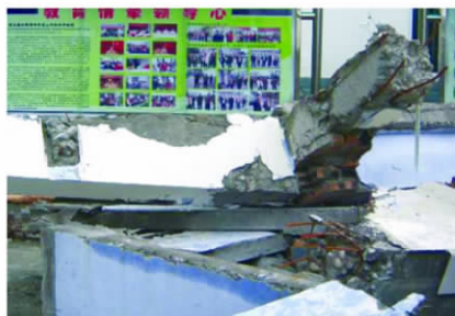
图 17 倒塌结构中的“卵石混凝土”(聚源中学)
