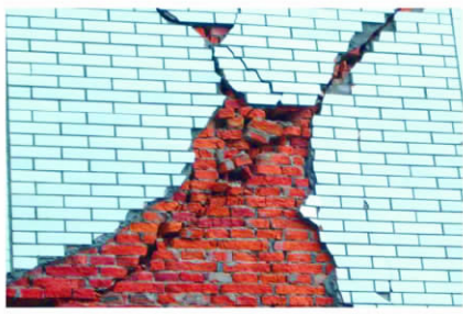
图 14 砖墙的开裂、破碎(汉旺镇)
