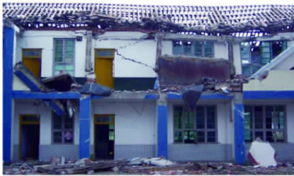
(b) 砖-预制板结构二层楼房严重受损(通济学校)
