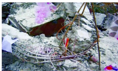
图 15 状如豆腐渣的破碎混凝土构件(聚源中学)
