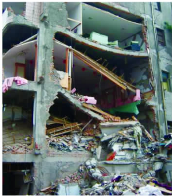
图 18 配置连续热轧钢筋圈梁的结构未倒塌(汉旺镇)
