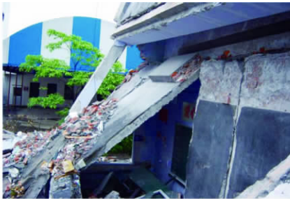
(c) 不规范砖混结构教学楼倒塌(聚源学校)
