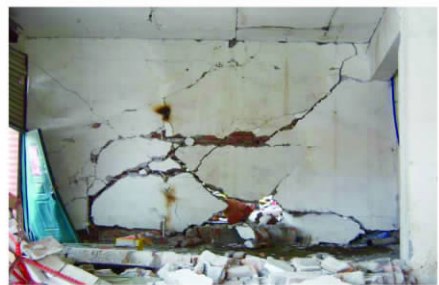
图12 下部墙体采用圈梁-构造柱约束的装配式楼盖未破坏(小渔洞商场)
