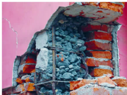
图 16 施工质量极差的“蜂窝混凝土”(汉旺镇)
