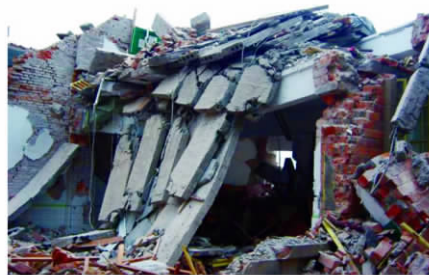
图6 无圈梁-构造柱教学楼的倒塌(汉旺镇学校)
