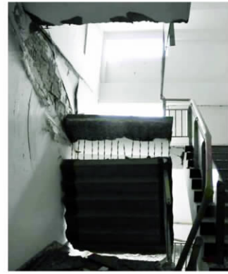
图 20 冷轧扭钢筋楼梯板断裂(冯远提供)
