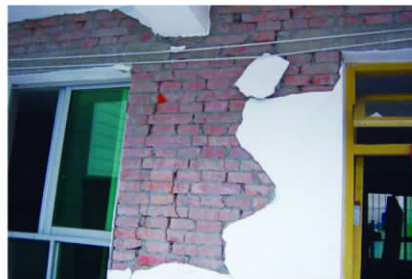
图7 底层窗间墙严重受损濒临倒塌(小渔洞学校)
